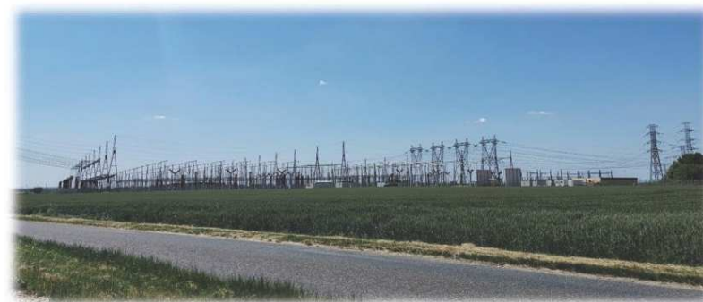
Figure 54 : Photographie du poste électrique RTE Gâtinais (Source : NCA Environnement)
