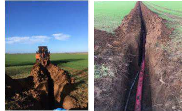
Figure 31 : Réalisation de la tranchée et de la pose du câble (Source : ENERCON)
